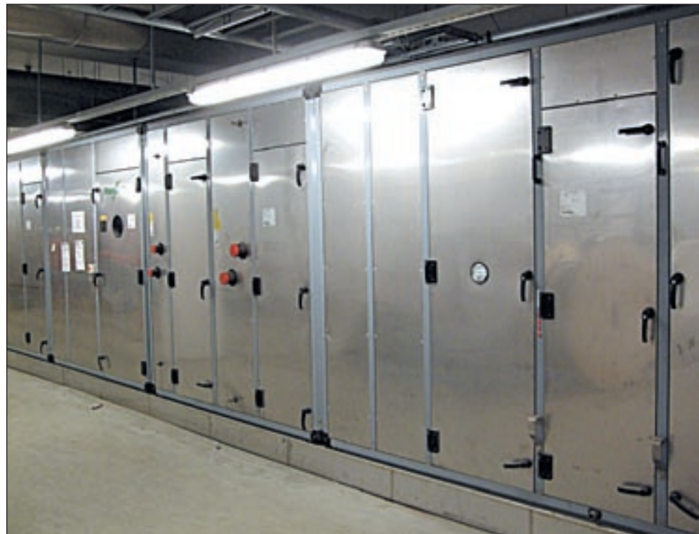
Fra ventilasjonsteknisk anlegg.
